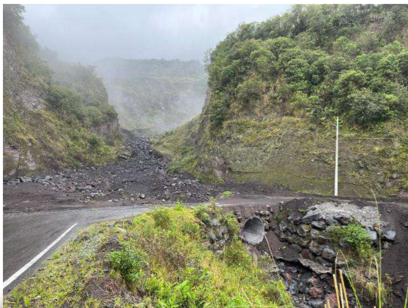
Ilustración 5. Quebrada de Achupallal propensa a colapsar la vía
